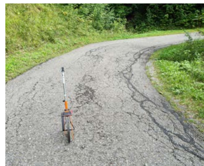
■ Diverse Strassenabschnitte sind schadhaft und sollen saniert werden.
