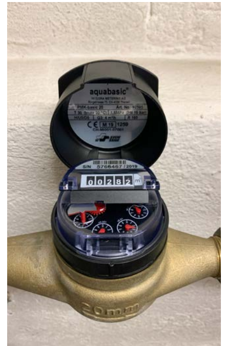
■ Mit der Wasseruhr wird der jährliche Verbrauch gemessen.
