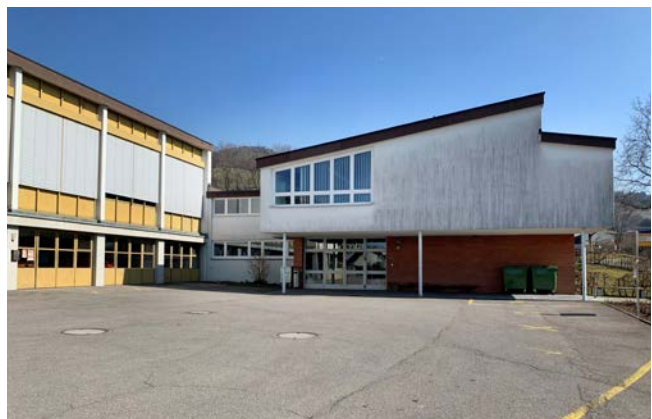
Das OSZ II ist stark sanierungsbedürftig und soll einem Ersatzbau weichen.
